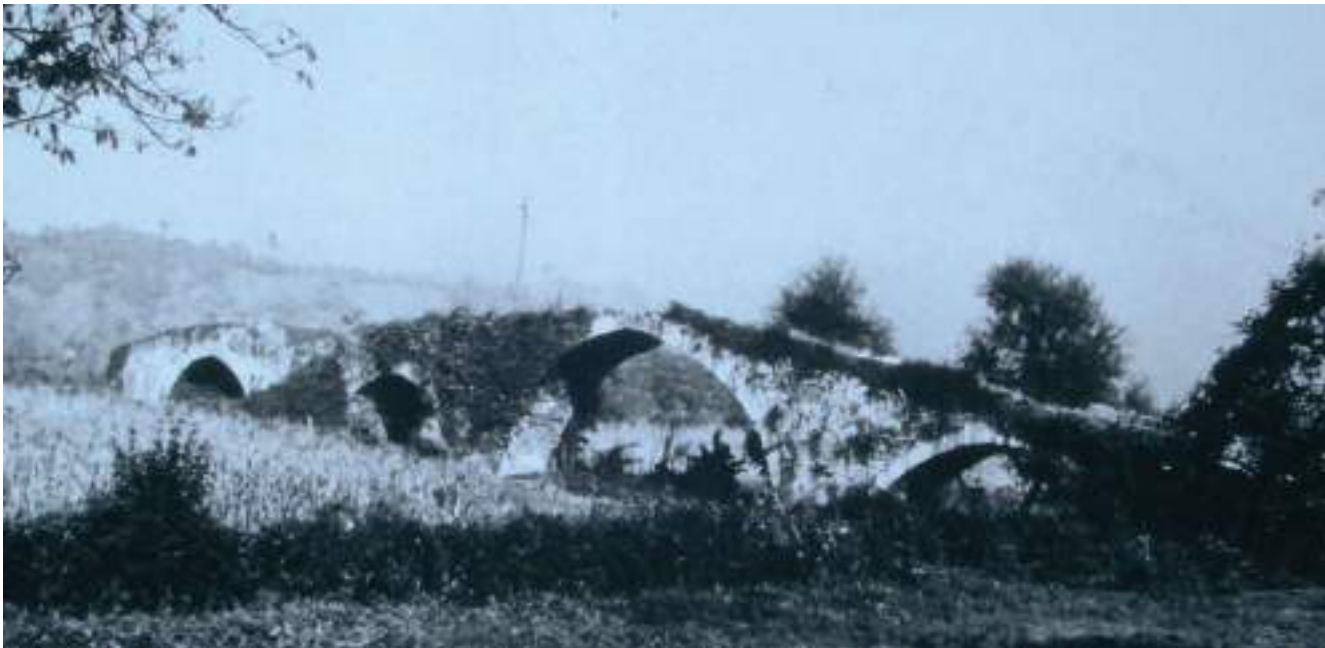
Figura 9. Vista general, aguas abajo. (Carlos Fernández Casado, Historia del puente en España)
