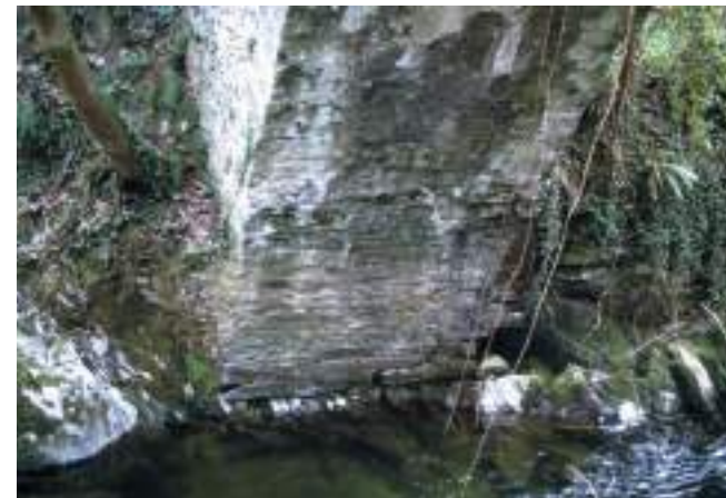
Figura 269. Detalle del descalce de la bóveda. (J. Belón González)
