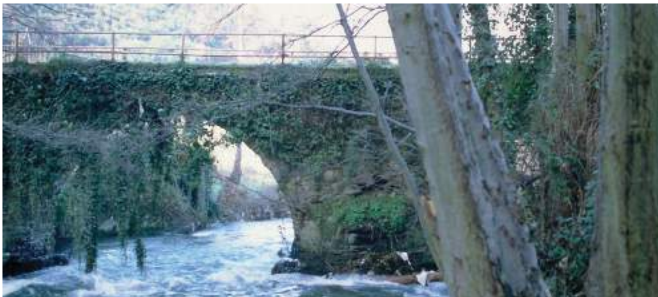
Figura 236. Vista, aguas arriba, del puente más moderno en dirección a Pixán. (J. M. Fdez. Hevia)
