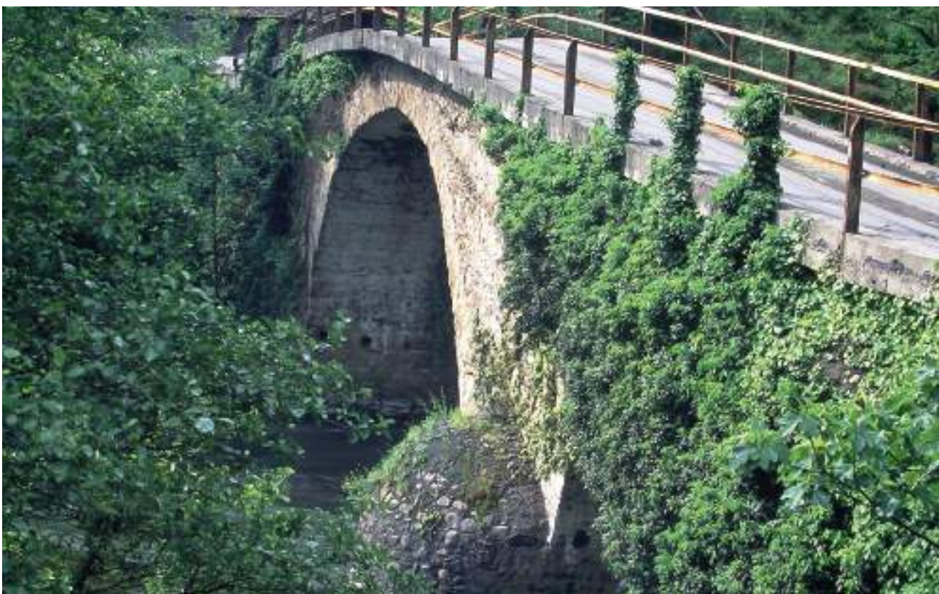
Figura 279. Losa de hormigón superpuesta para ensanchar el puente de Villanueva; en la zona central se adapta al trazado de la bóveda. (J. M. Fdez. Hevia)
