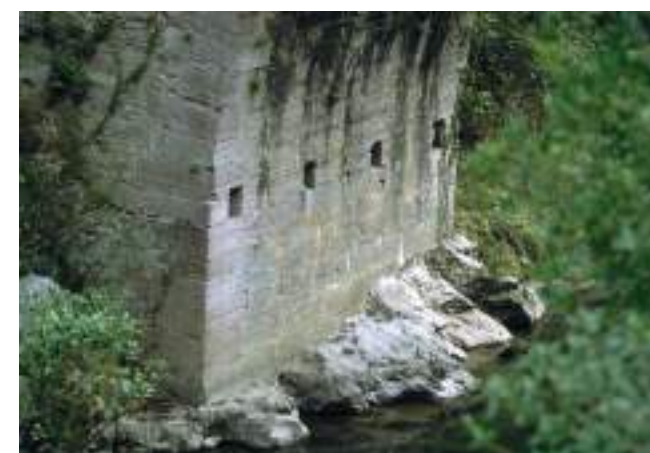
Figura 180. Detalle de la cimentación sobre roca y arranque del arco, con sus mechinales. (J. M. Fdez. Hevia)
