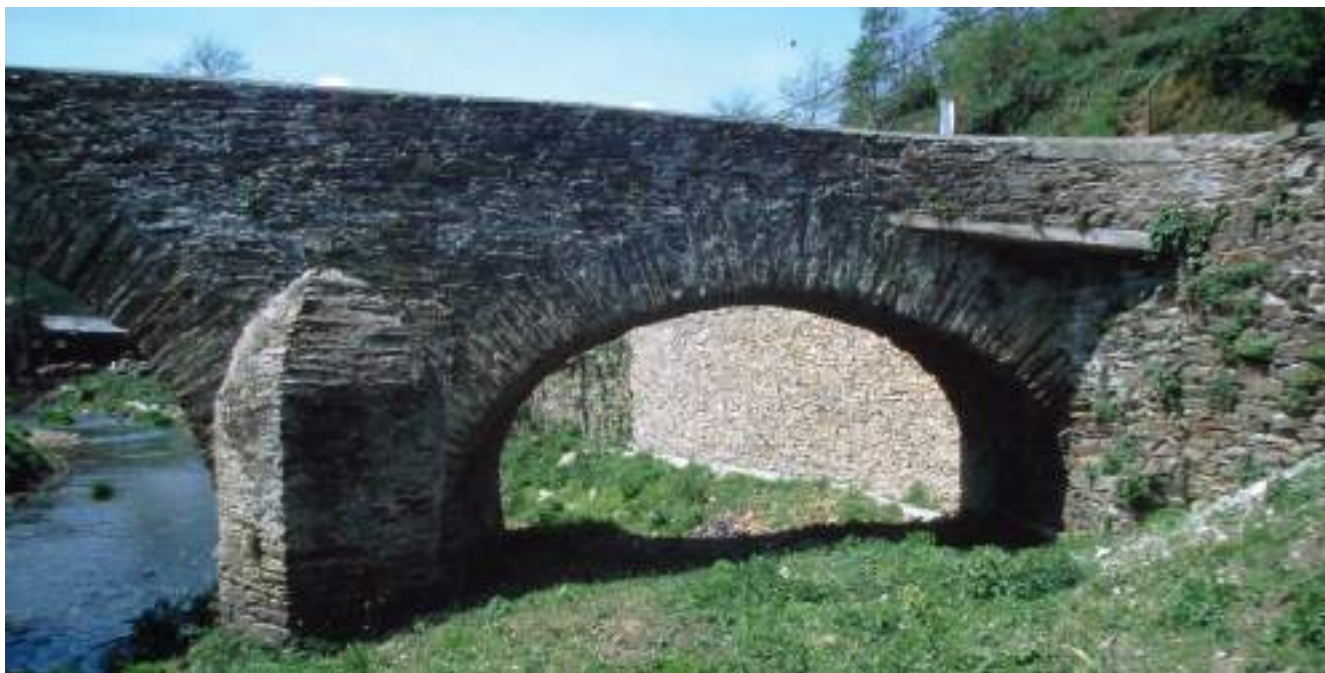
Figura 112. Detalle del tajamar y la bóveda de la margen derecha. (J. Belón González)
