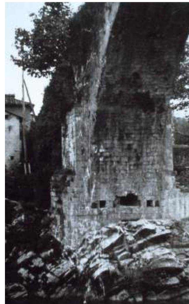
Figura 45e. Detalle de los agujeros realizados en las pilas para las cargas explosivas. (BNE)
