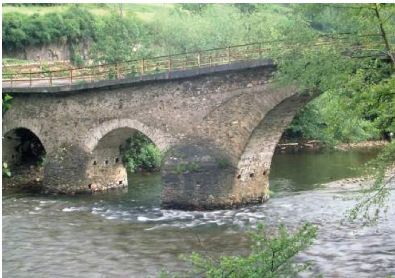
Figura 276. Vista parcial, aguas arriba, del puente de Villanueva. (J. M. Fdez. Hevia)
