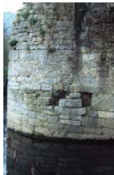
Figura 79. Detalle de un espolón, con sucesivas intervenciones. (J. Belón González)
