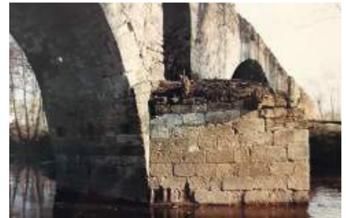
Figura 60. Detalle de la fábrica del tajamar y el interior del arco. (J. M. Fdez. Hevia)
