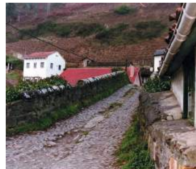
Figura 261. Estado de la calzada en 1991. (Elena Ruiz)
