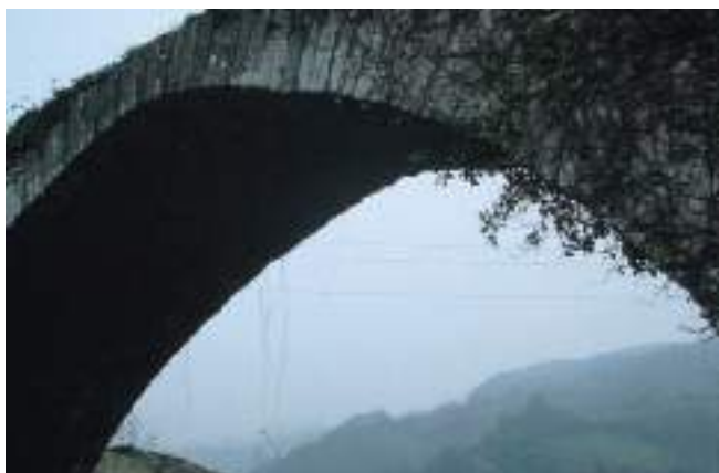
Figura 15. Desplazamiento de las dovelas en la bóveda central, aguas arriba. (J. Belón González)
