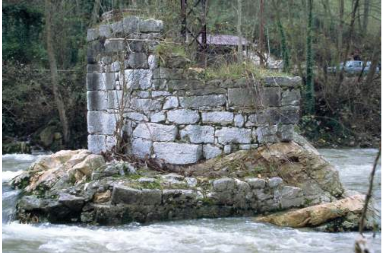
Figura 199. Pila del puente de San Andrés de Trubia. (J. M. Fdez. Hevia)
