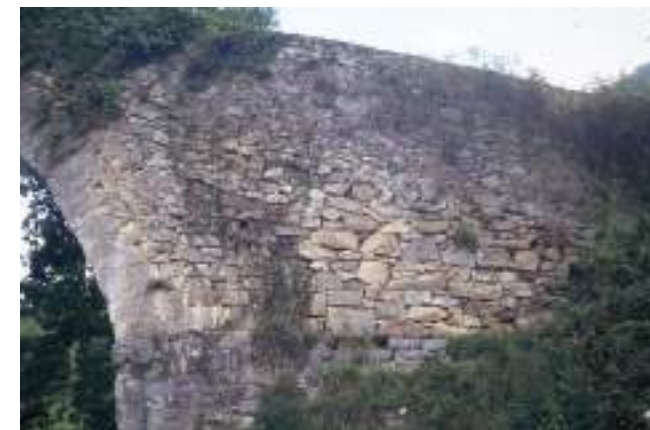
Figura 175. Estribo derecho, aguas arriba, claramente intervenido y con fábrica poco uniforme. (J. M. Fdez. Hevia)
