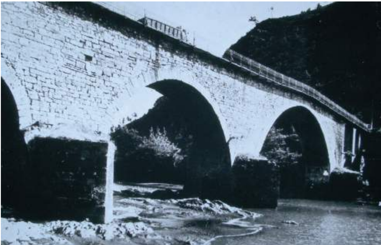
Figura 94. Vista lateral, aguas abajo, con espolones ojival, triangular y ojival de base triangular, todos a la misma altura. (Carlos Fernández Casado, Historia del Puente en España)
