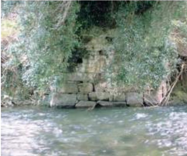
Figura 183. Detalle del arranque del arco en la margen derecha. (J. M. Fdez. Hevia)
