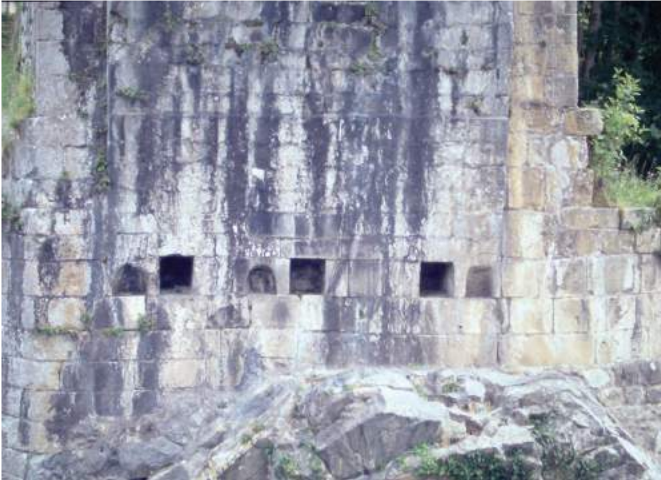
Figura 51. Detalle del intradós de la bóveda mayor, con mechinales y línea de retranqueo por encima de ellos. (J. M. Fdez. Hevia)
