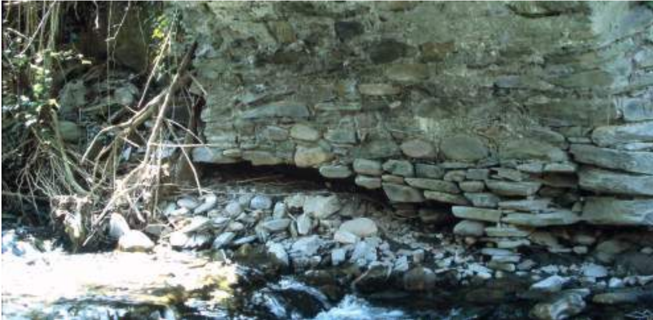
Figura 230. Detalle del intradós en la margen izquierda. (J. Belón González)
