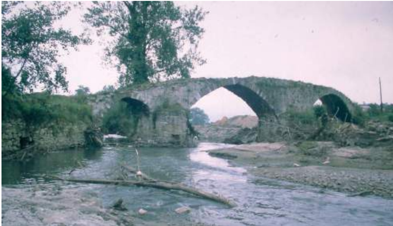
Figura 23. Vista, aguas arriba, con el antiguo muro de encauzamiento, destruido, a la izquierda. (J. M. Fdez. Hevia)
